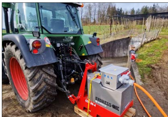
Der Zapfwellen-Generator im Betrieb; mittels Kabel wird der Strom zur Not-Einspeisung des Pumpwerks geführt.
